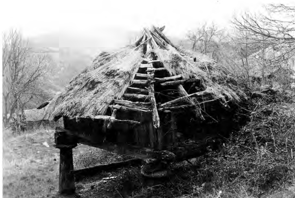
O estado de conservación do hórreo colmado é moi malo, cada ano que pasa quedalle menos colmo.
