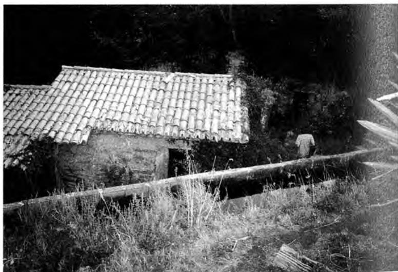
16. Estado actual (deplorable) do conxunto etnográfico do Mosquetín: o tellado restaurado en 1985 cada vez esta máis estragado.
