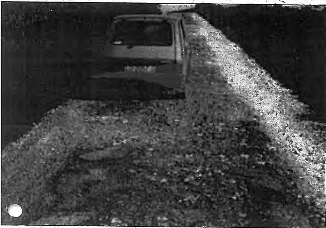
Estado de la carretera en uno de sus puntos
